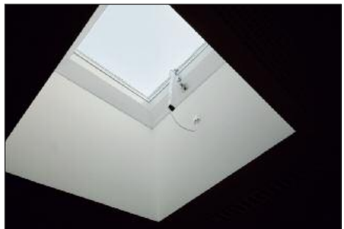
Der Linearantrieb sorgt für ein bequemes Öffnen und Schließen der Lichtkuppeln. So erfolgt die Entrauchung im Brandfall zuverlässig und komfortabel.
